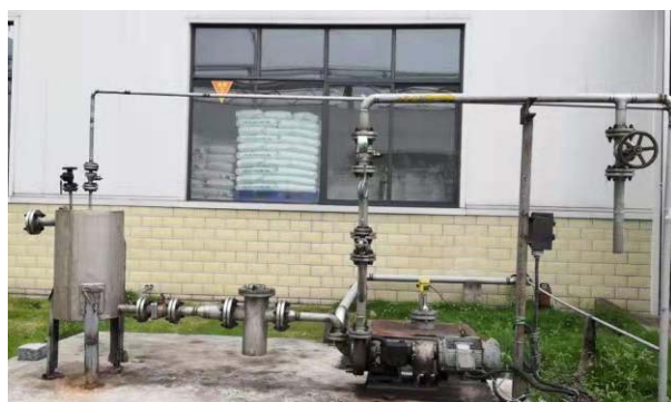
废水处理站出口
