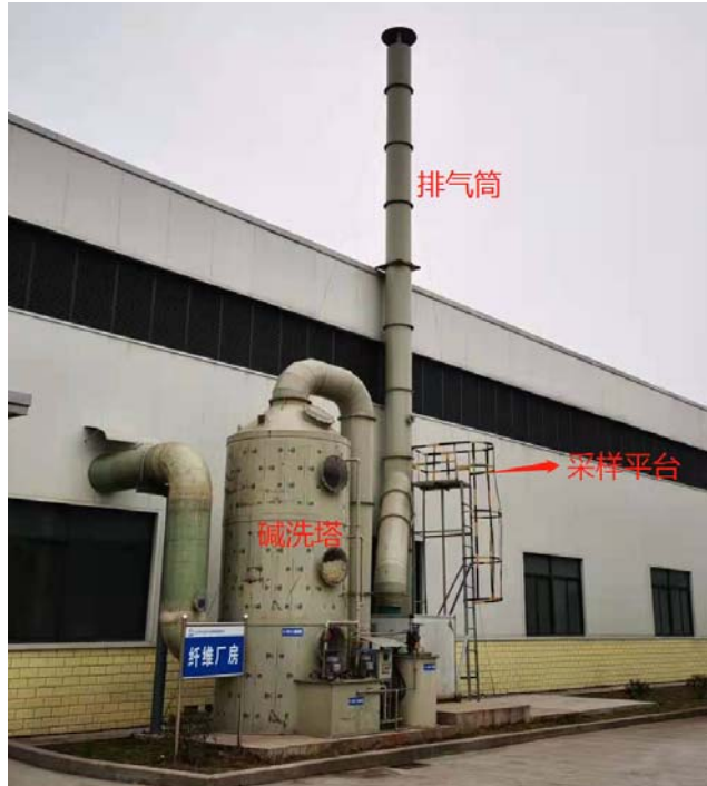
挤出废气碱洗塔、排气筒及采样平台
